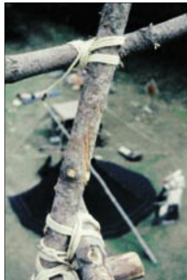
SoLa, auf saubere Bünde wurde Wert gelegt, schließlich sollte der Lagerturm nicht nur stabil, sondern auch schön sein.
