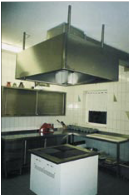
2003, die Küche wurde 1975 fertig gestellt. Nach diesen vielen Jahren brauchte es neue Fliesen, Einrichtung und vor allem einen Dunstabzug.
