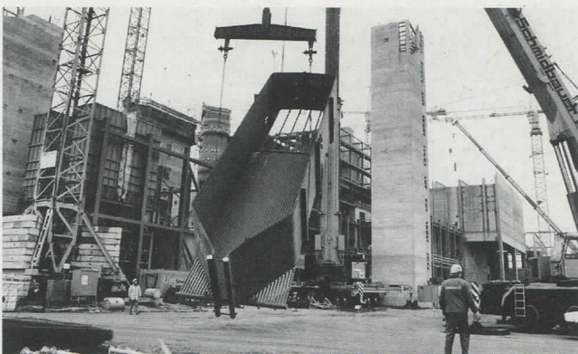
Die neue Schmelzbrennanlage gilt als richtungsweisendes Projekt. Sie sichert über Jahre hinaus eine Müllentsorgung mit weniger Reststoffen und einer höheren Verwertungsquote.
